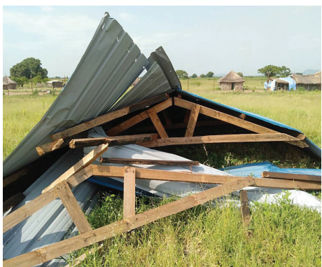
Spadnutá strecha po silnej búrke
